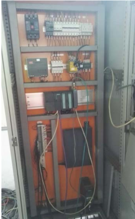
图4 主站PLC电气柜。
