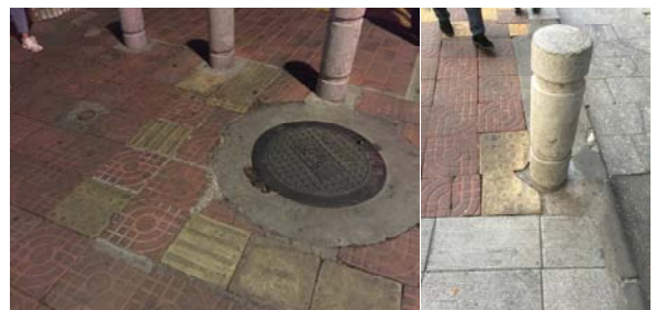
图13 不连续的盲道铺装 (图片来源: 自摄)。
