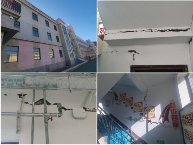
图7 拉孜县中学震害。
