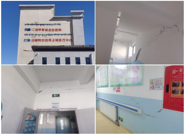
图6 拉孜县中心医院震害。
