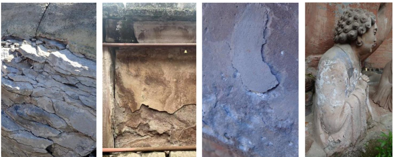
图2 温度作用下岩体层状差异剥落。
